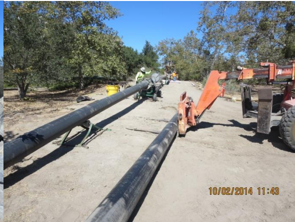
Effluent Force Main
